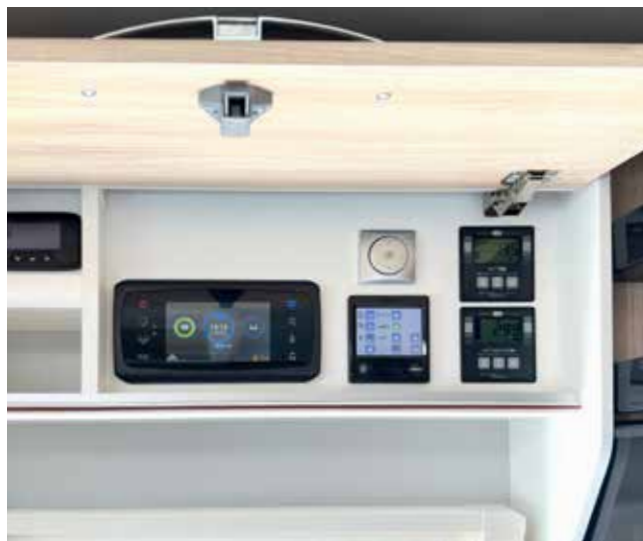
Central styrning - användarvänlig och tydlig
